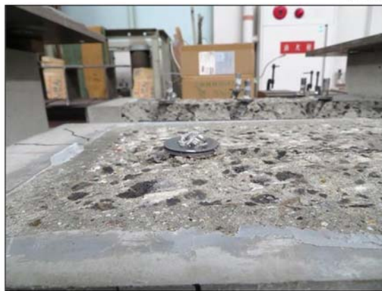
(c) アンカー筋の破断
